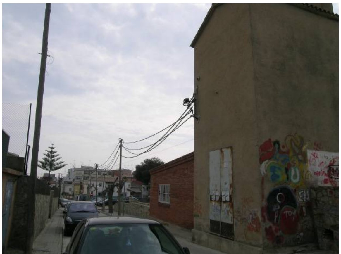
Estació transformadora del Torrent de Santa Anna
