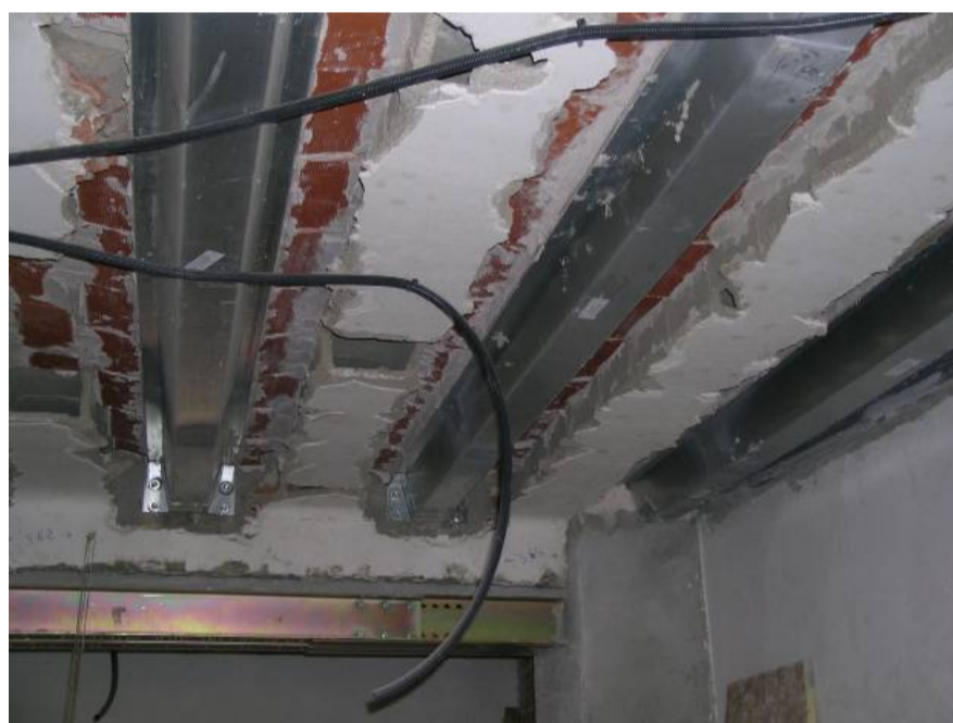
Edifici afectat de degradacions estructurals
