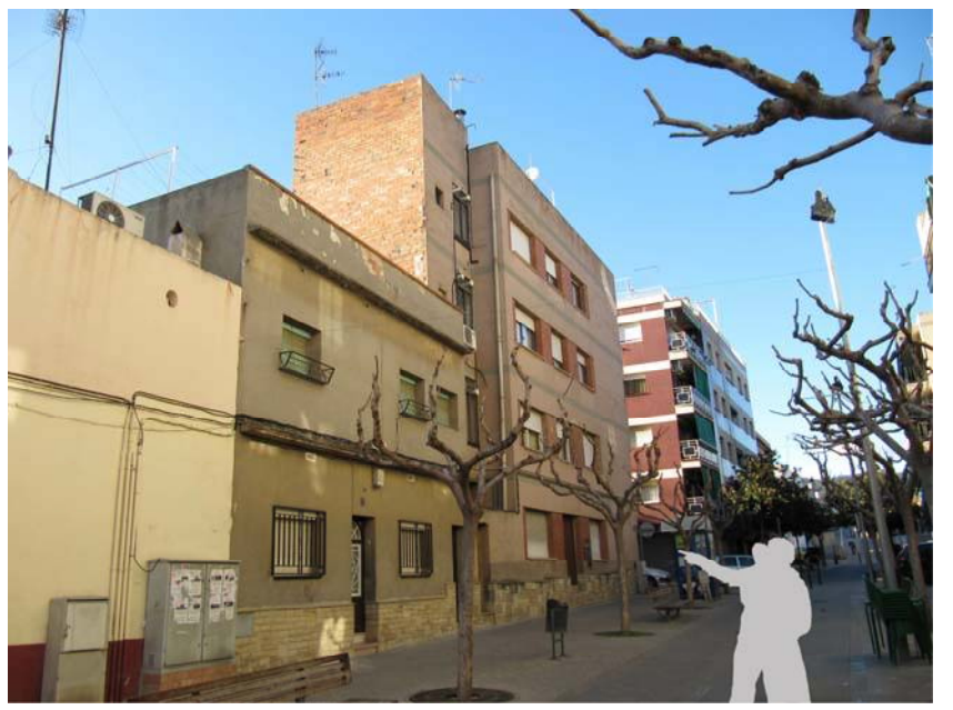
Edificacions al Torrent de Santa Anna en mal estat de conservació
