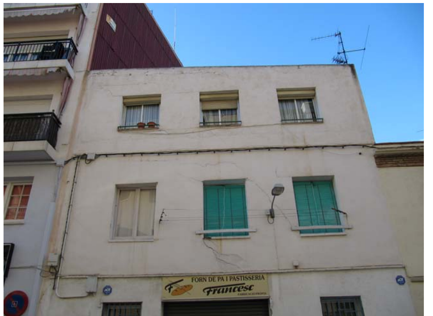
Edificacions Carrer Jacint Verdaguer en mal estat de conservació
