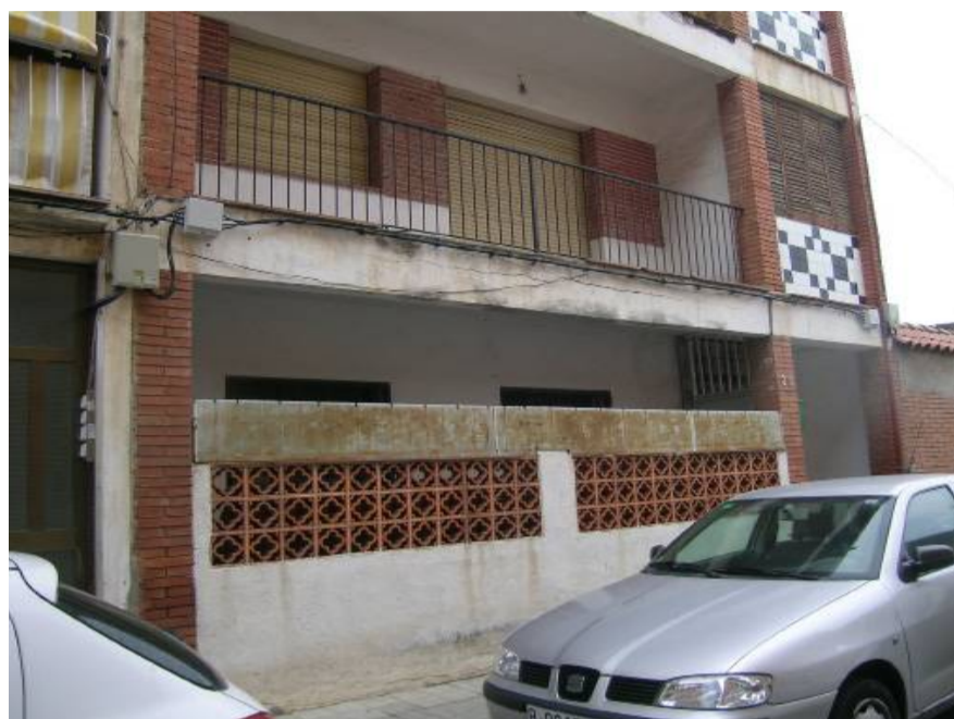
Degradacions estructurals severes
