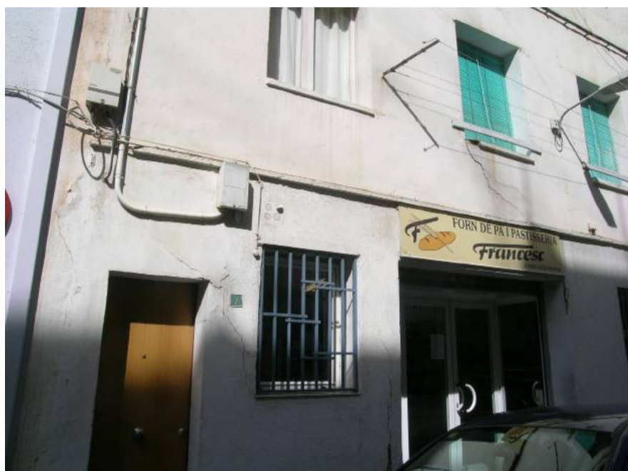
Esquerdas importants sobre façana per defectes en fonaments
