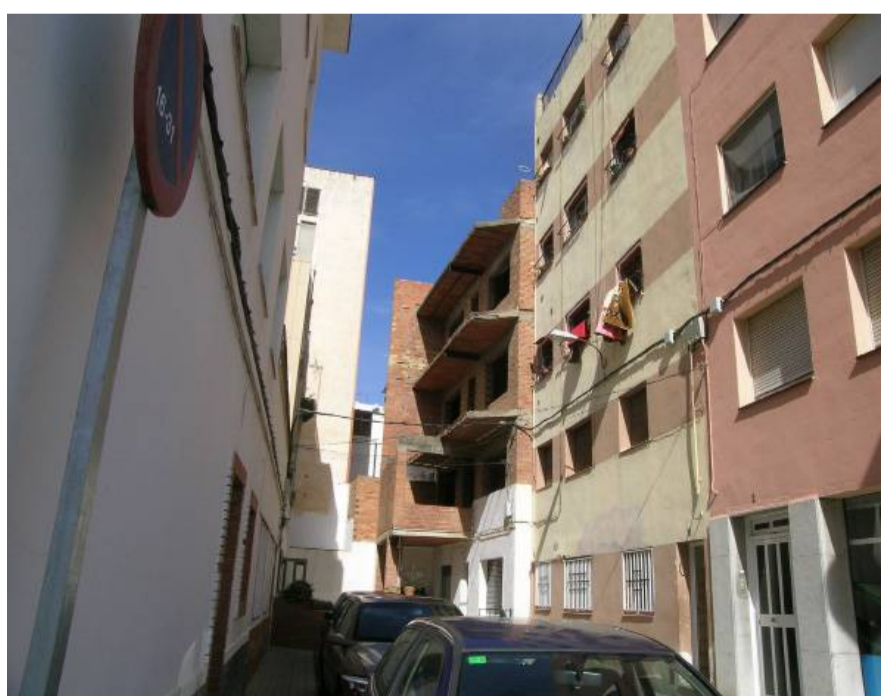
Obra inacabada en estat ruïnós
