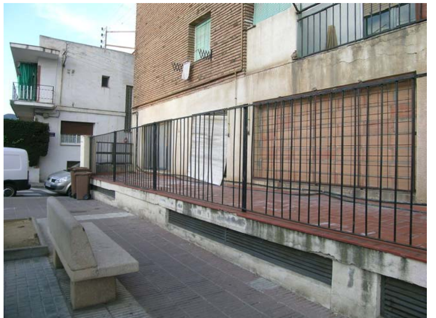
Locals en precàries condicions de manteniment
