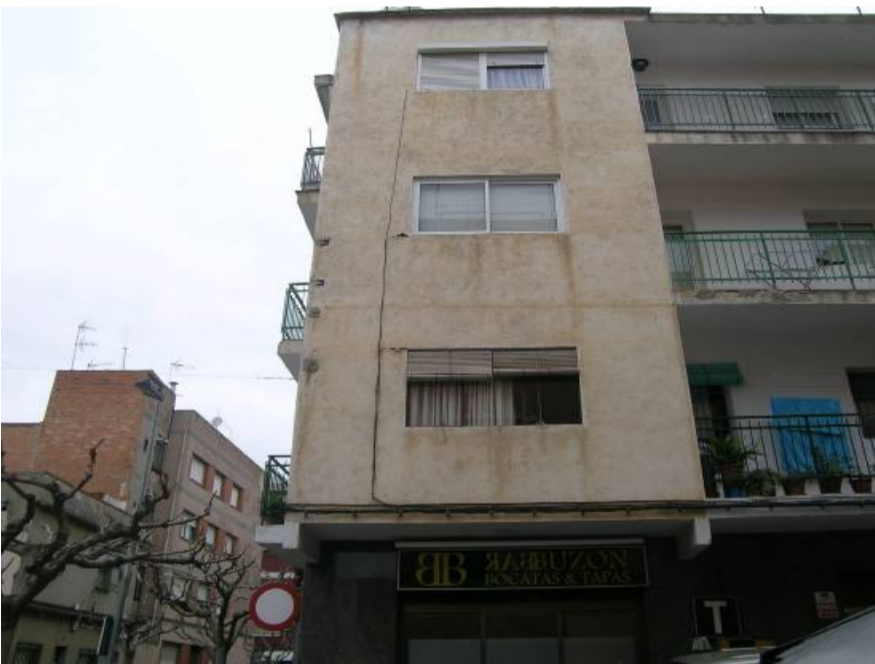
Degradació de revestiments en paraments
