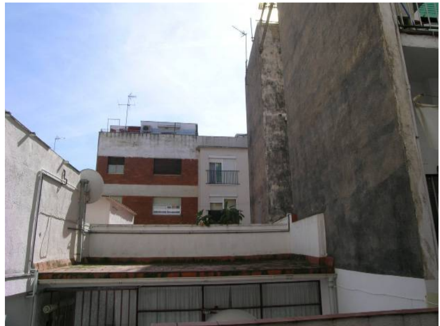
Degradació de revestiment en mitgeres
