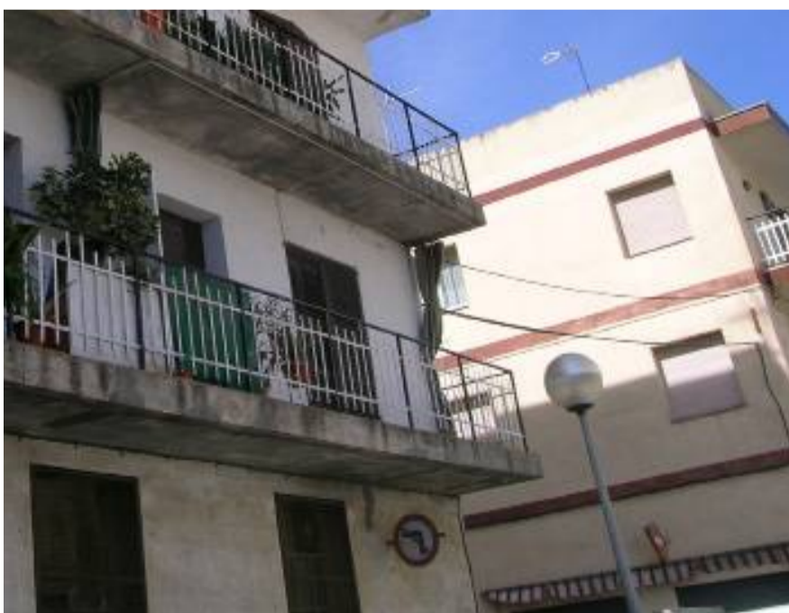
Degradació de revestiments en terrasses
